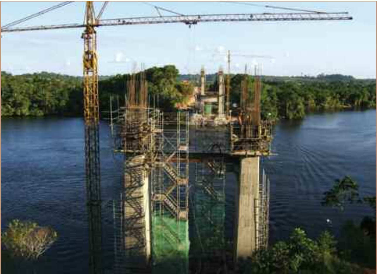
Les travaux du pont sur l'Oyapock, vus de la rive française, octobre 2010. Cliché F. Grenand.
